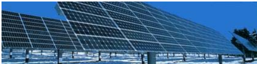
La centrale photovoltaïque du Mont-Soleil
